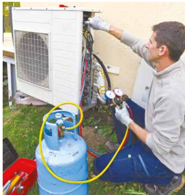
La pompe à chaleur doit être entretenue par un professionnel qualifié.
